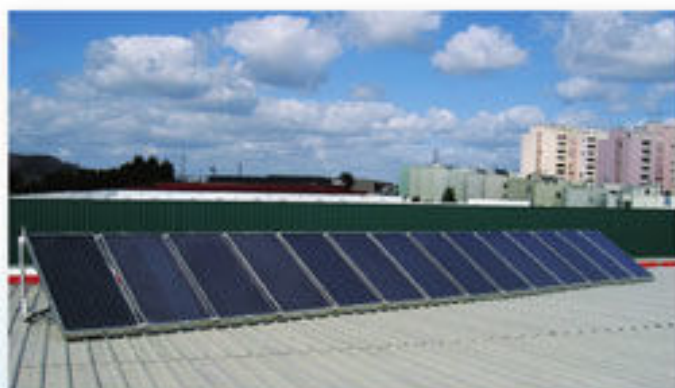
Aquecimento de 2 000 litros/dia em ginásio
