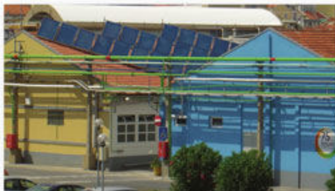
Aquecimento de 4 000 litros/dia nos balneários da Solvay Portugal
